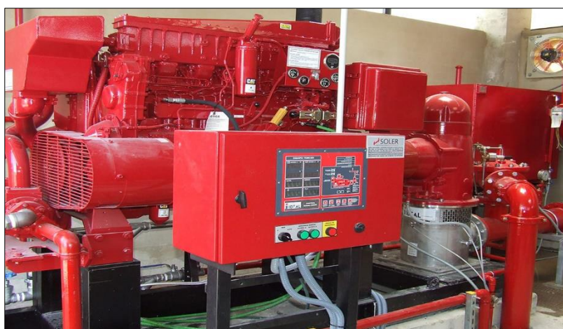
Figura 8. Sistema fijo de extinción de incendios de polvo químico seco. Fuente: Recuperado de https://pcccthaibinh.com
