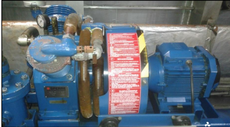
Figura 10. Neumático en la sala de máquinas.
