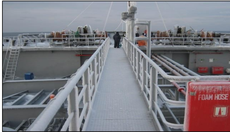
Figura 11. Equipos contra incendio de cubierta en zonas polares. Fuente: Recuperado de https://www.capitalship.gr/galleries/photo-galleries/2-vessels-trading-in-ice-conditions/
