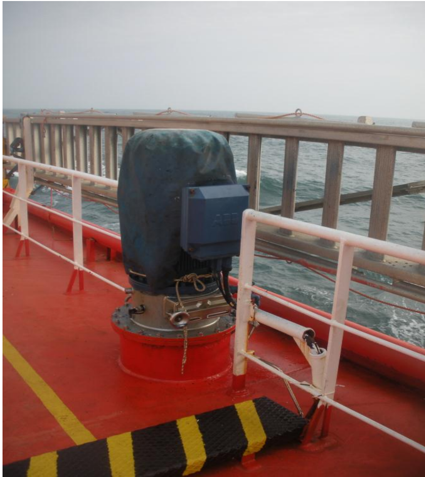
Figura 14. Motor eléctrico de la bomba, sobre la cubierta principal Fuente. García (2015)
