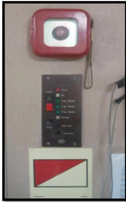
Figura 10: Panel contra incendios.
