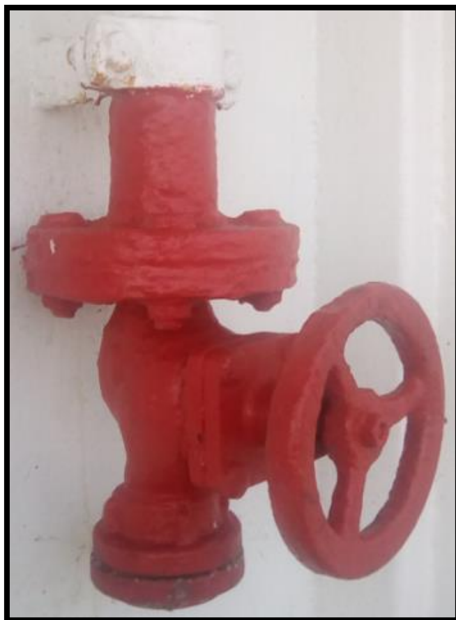
Figura 9: Hidrante contra incendios.
