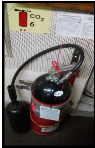
Figura 15: Extintor portátil de CO2.
