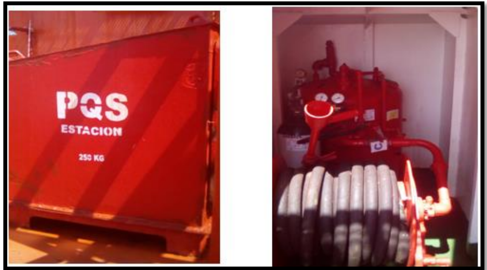
Figura 7: Estación fija de PQS.
