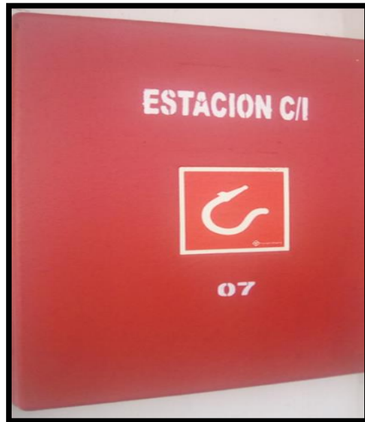
Figura 8: Estación contra incendios.
