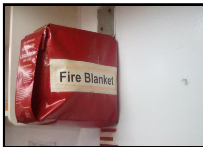
Figura 16: Mantas contra incendios.
