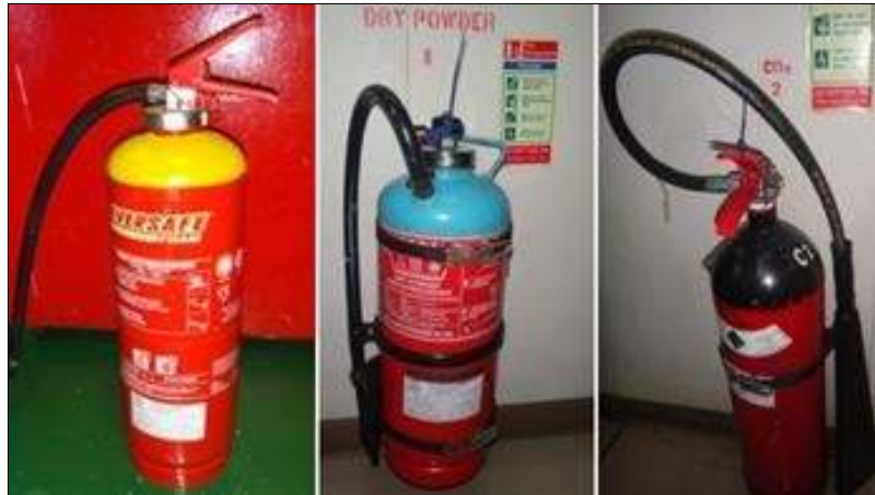
Figura 18. Extintores a bordo del buque.
