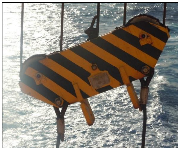
Figura 17. Roldana del gancho del pescante del bote de caída libre bloqueado por falta de lubricación.
