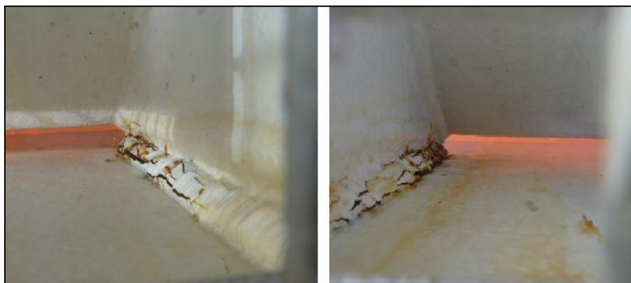
Figura 18. Óxido en las soldaduras de las uniones en la estructura del pescante.
