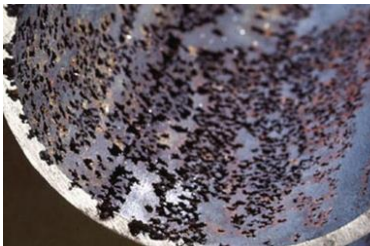
Figura 7. Corrosión Pitting en tubería de caldera.
