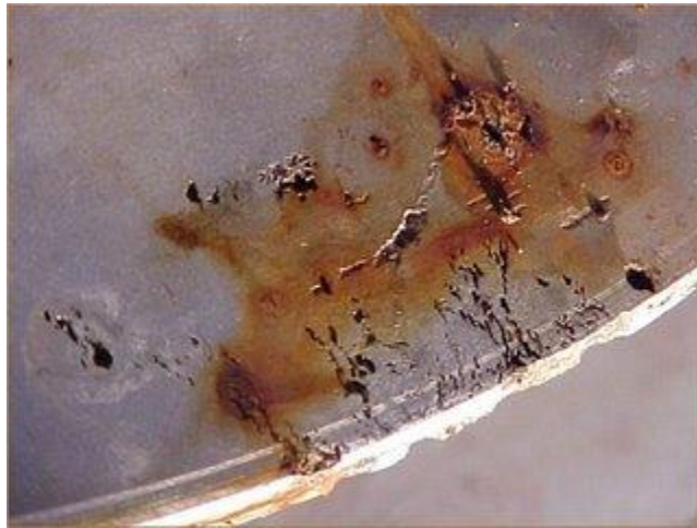
Figura 8. Agrietamiento por corrosión por estrés
